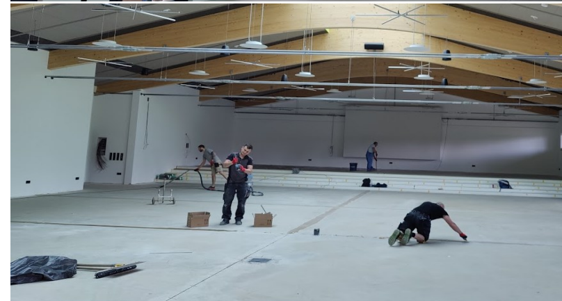
Präsentationswand fertig Stufen zur Bühne verlegt und Parkett Tanzboden und Bodenbelag Halle wird verlegt.
